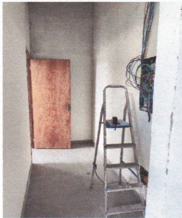
PONTOS / CIRCUITOS ELÉTRICOS E KIT DE PORTA DE MADEIRA COM FECHADURA (PREFEITURA SEDE)
