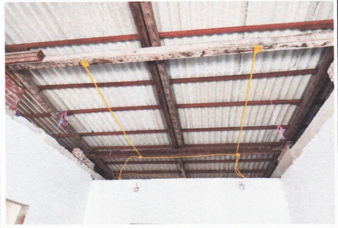
PONTOS / CIRCUITOS ELÉTRICOS (PREFEITURA SEDE)
