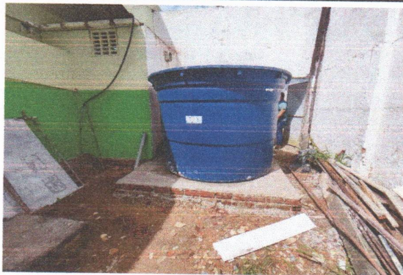
ESCOLA MUNICIPAL INÁCIO GOMES DA SILVA - CAIXA D'ÁGUA 5.000L (RESERVATÓRIO INFERIOR)
