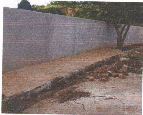
ESCOLA MUNICIPAL ERCINA LAPENDA - ATERRO MANUAL E APLICAÇÃO DE SELADOR NO MURO
