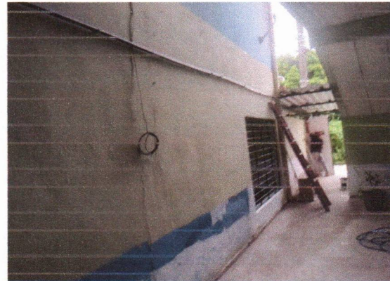
CRECHE MUNICIPAL TIO DUDU - PINTURA LÁTEX ACRÍLICA STANDARD, APLICAÇÃO MANUAL EM PAREDE.
