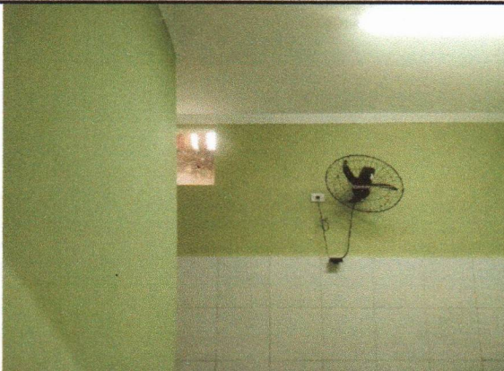
CRECHE MUNICIPAL TIO DUDU - PINTURA LÁTEX ACRÍLICA STANDARD, APLICAÇÃO MANUAL EM PAREDE.
