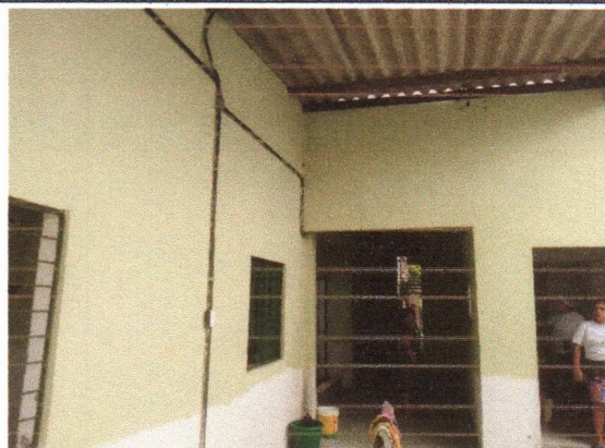
CRECHE MUNICIPAL TIO DUDU - PINTURA LÁTEX ACRÍLICA STANDARD, APLICAÇÃO MANUAL EM PAREDE.
