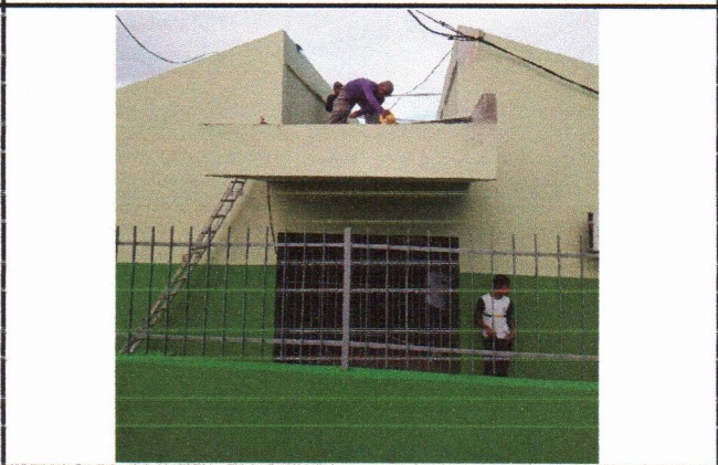
ESCOLA MUNICIPAL APOLÔNIO SALES - PINTURA DE GRADIL, PINTURA DE PAREDES, IMPERMEABILIZAÇÃO DE MARQUISE
