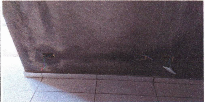
PONTO DE TOMADA (ANEXO FUNDOS)
