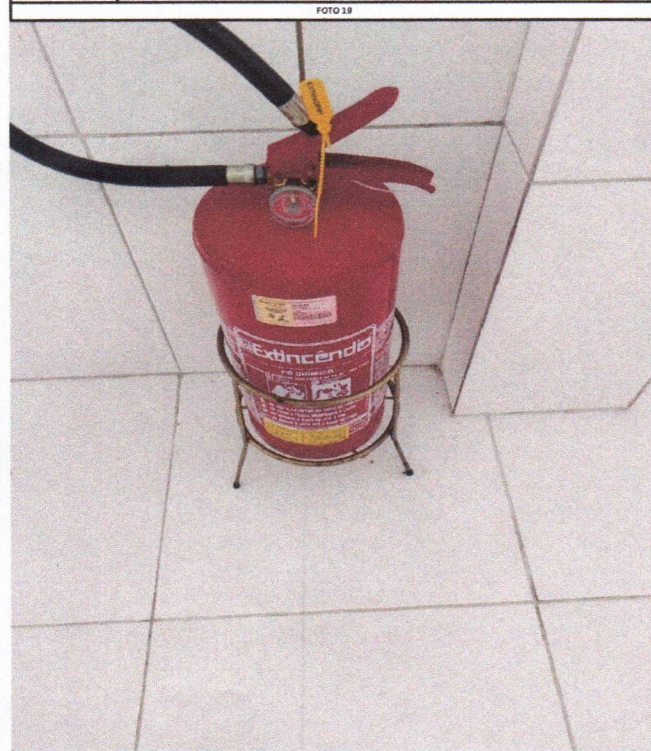
extintor e placa
