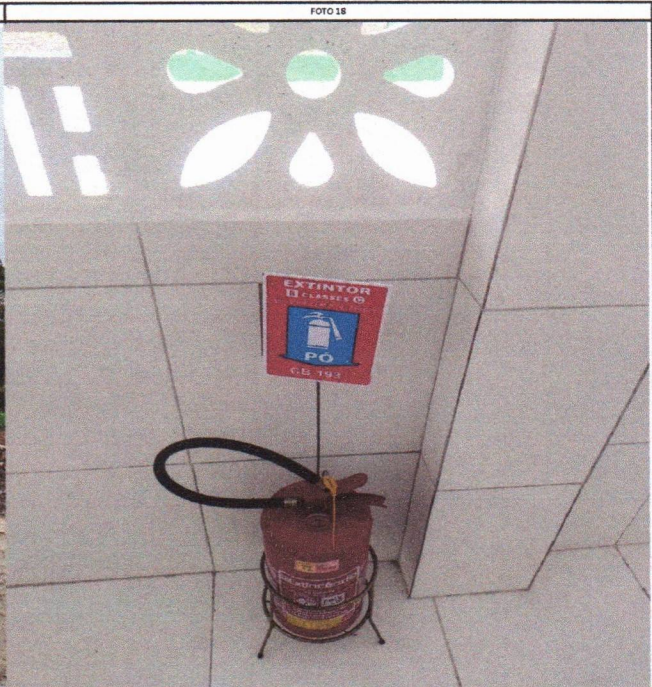
extintor e placa
