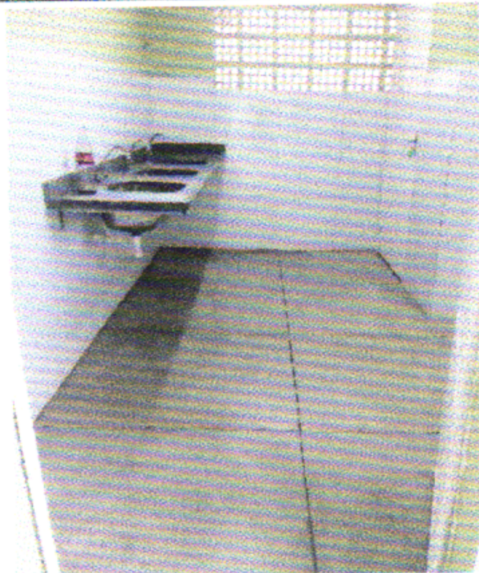
SIFÃO, ENGATE, TORNEIRA E REGISTRO
