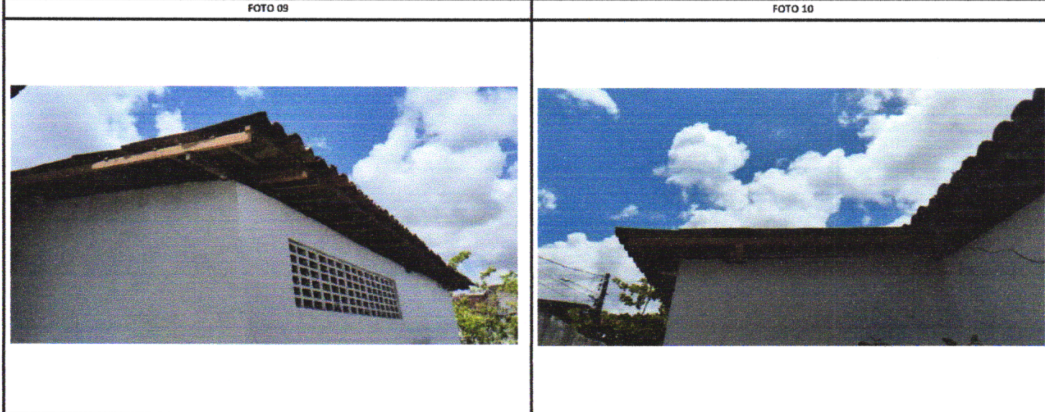
RETELHAMENTO E SUBSTITUIÇÃO DE TRAMA DE MADEIRA RETELHAMENTO E SUBSTITUIÇÃO DE TRAMA DE MADEIRA
