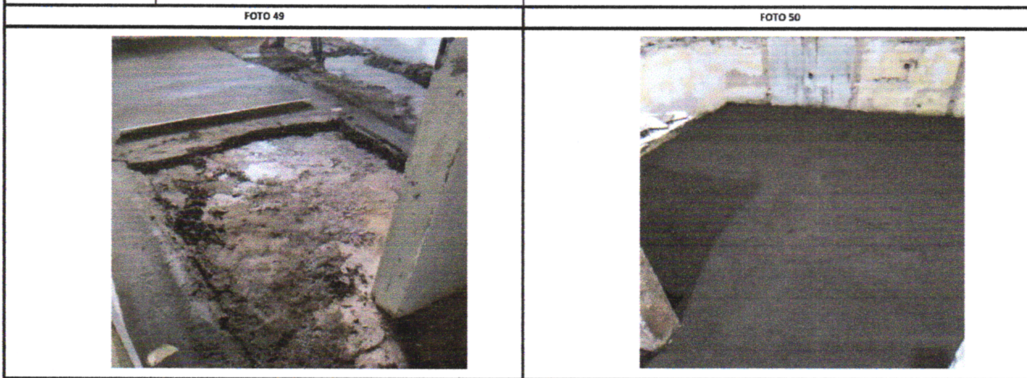
EXECUÇÃO DO PISO CIMENTADO EM TODOS OS AMBIENTES EXECUÇÃO DO PISO CIMENTADO EM TODOS OS AMBIENTES
