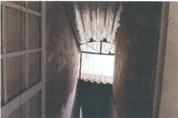
CHAPISCO E MASSA ÚNICA NA ELEVAÇÃO DE ALVENARIA DE VEDAÇÃO NA ÁREA DA ESCADA
