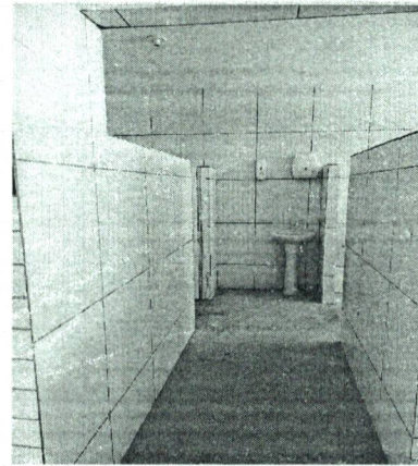
LAVATÓRIO COM COLUNA DO WC FEMININO
