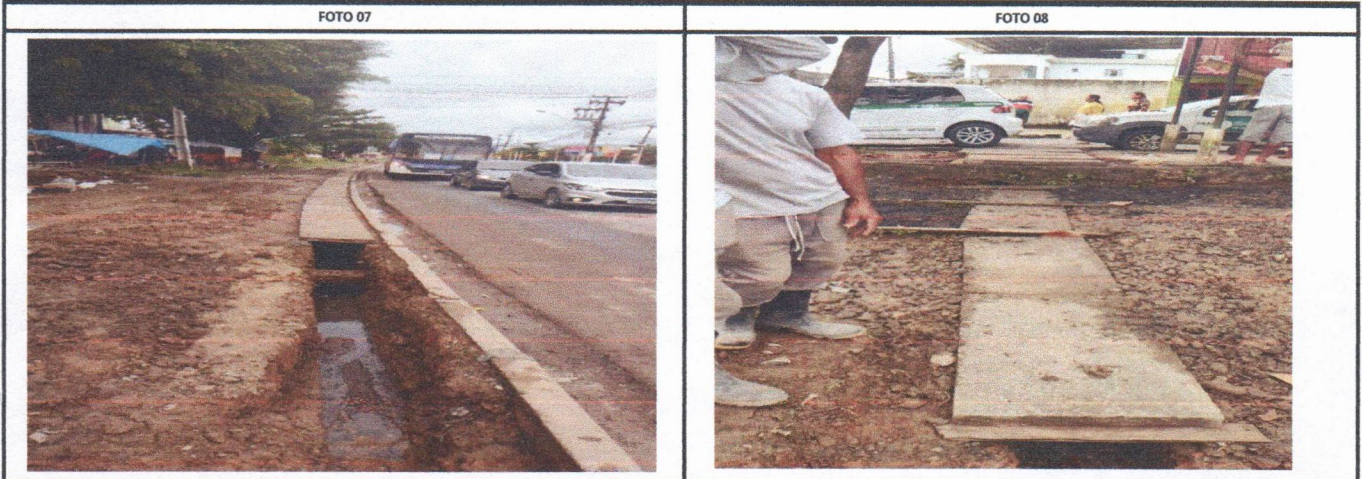
DRENAGEM CAIARA DRENAGEM CAIARA
