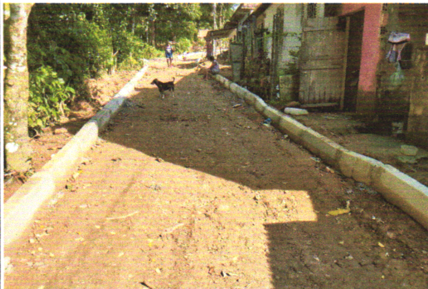
ASSENTAMENTO DE GUIA (MEIO-FIO) EM TRECHO RETO, CONFECCIONADA EM CONCRETO PRÉ-FABRICADO, DIMENSÕES 100X15X13X30 CM (COMPRIMENTO X BASE INFERIOR X BASE SUPERIOR X ALTURA) PARA VIAS URBANAS (USO VIÁRIO). AE_06/2016
