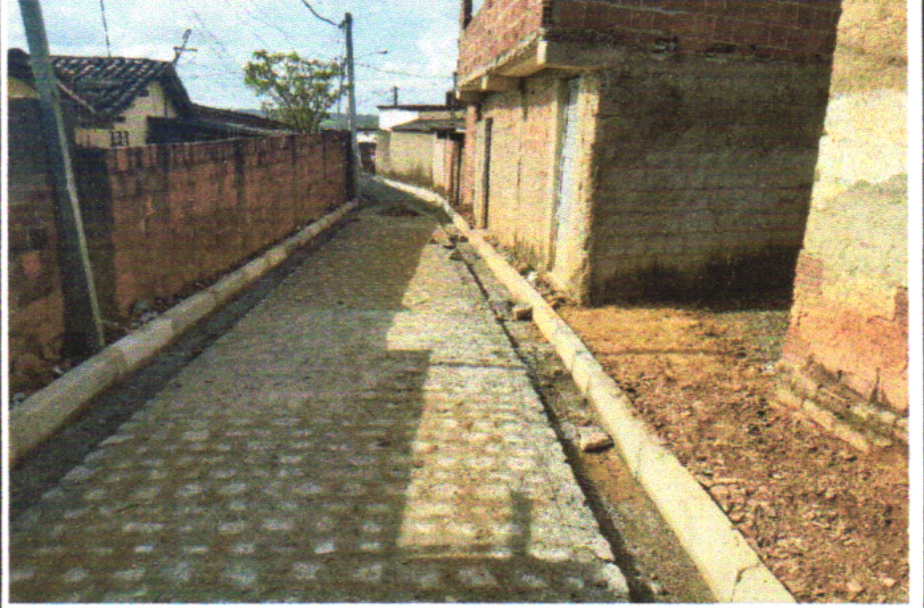
EXECUÇÃO DE PAVIMENTO EM PARALELEPÍPEDOS, REJUNTAMENTO COM ARGAMASSA TRAÇO 1:3 (CIMENTO E AREIA). AF_05/2020
