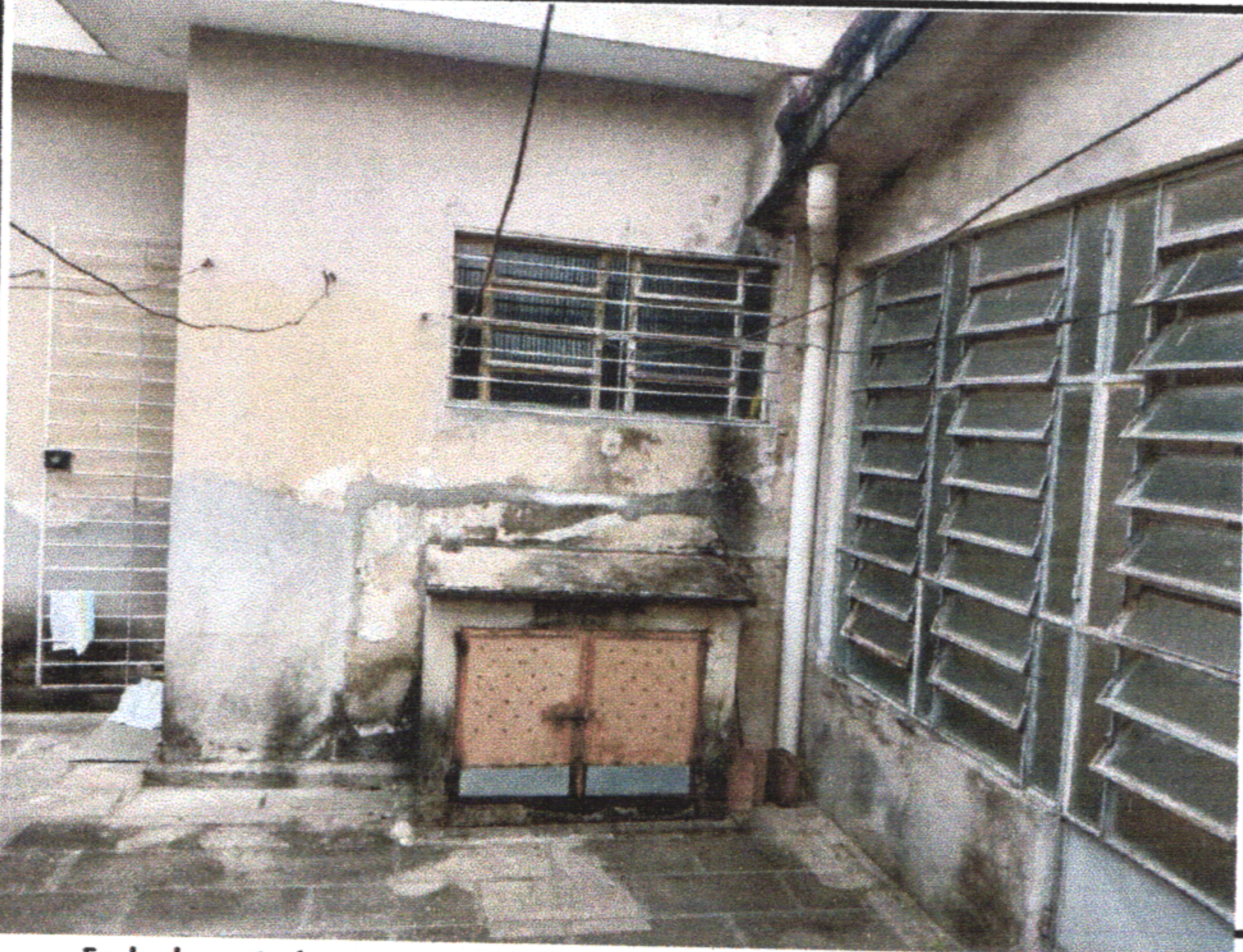
Fachada posterior apresenta mofo nas paredes e a pintura das Grades e esquadrias deterioradas
