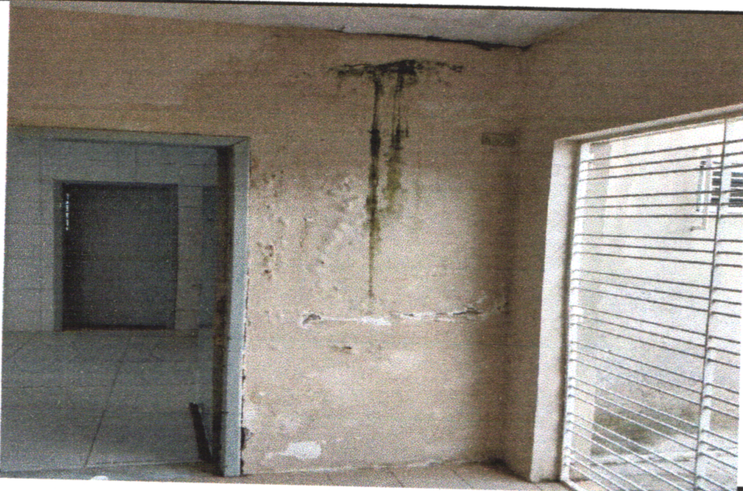
Vazamento na calha
