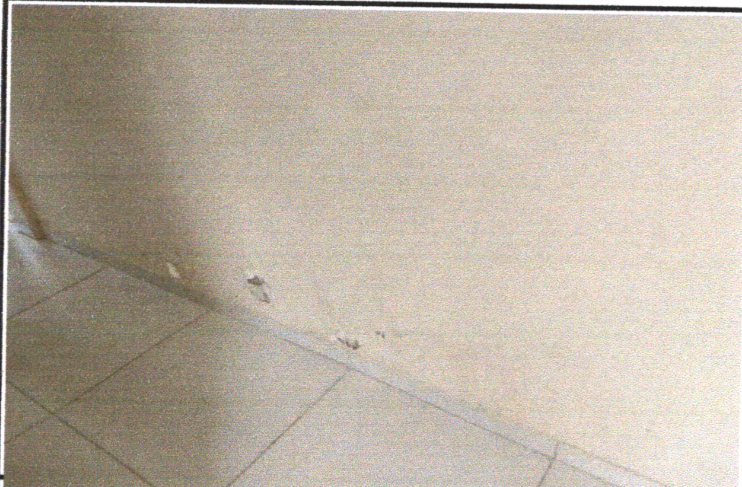
Parede da sala com pintura e reboco deteriorado por conta de infiltração por meio de percolação
