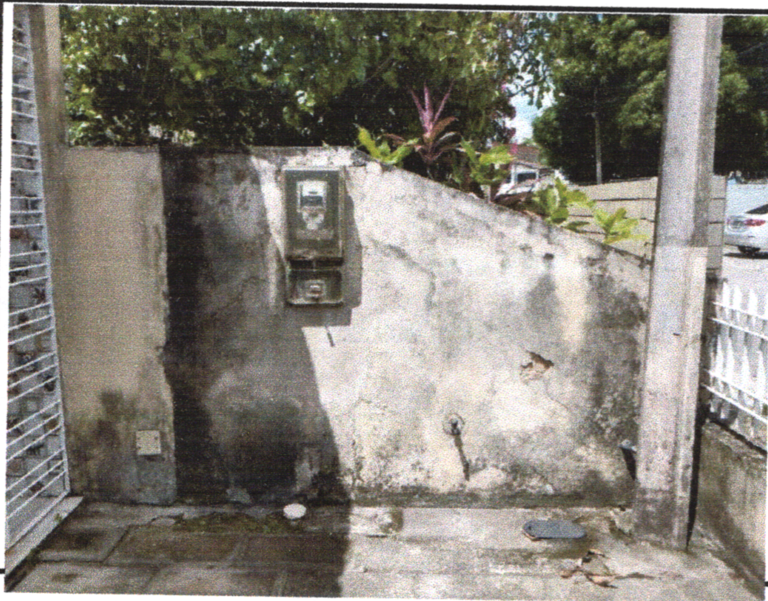
Quadro elétrico Trifásico mais a pintura apresenta mofo e o reboco está deteriorado
