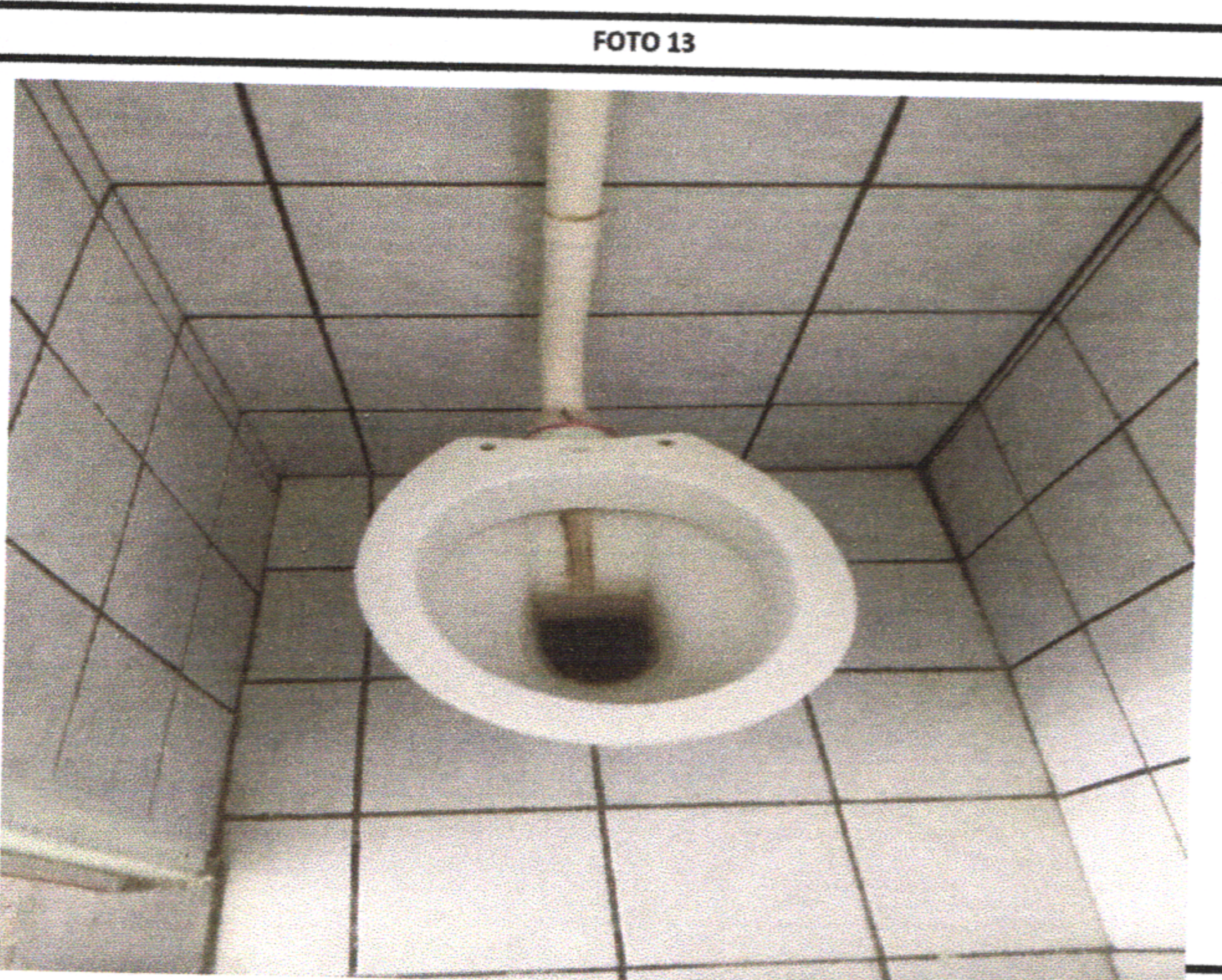
Vaso sanitário do depósito entupido e descarga não funciona
