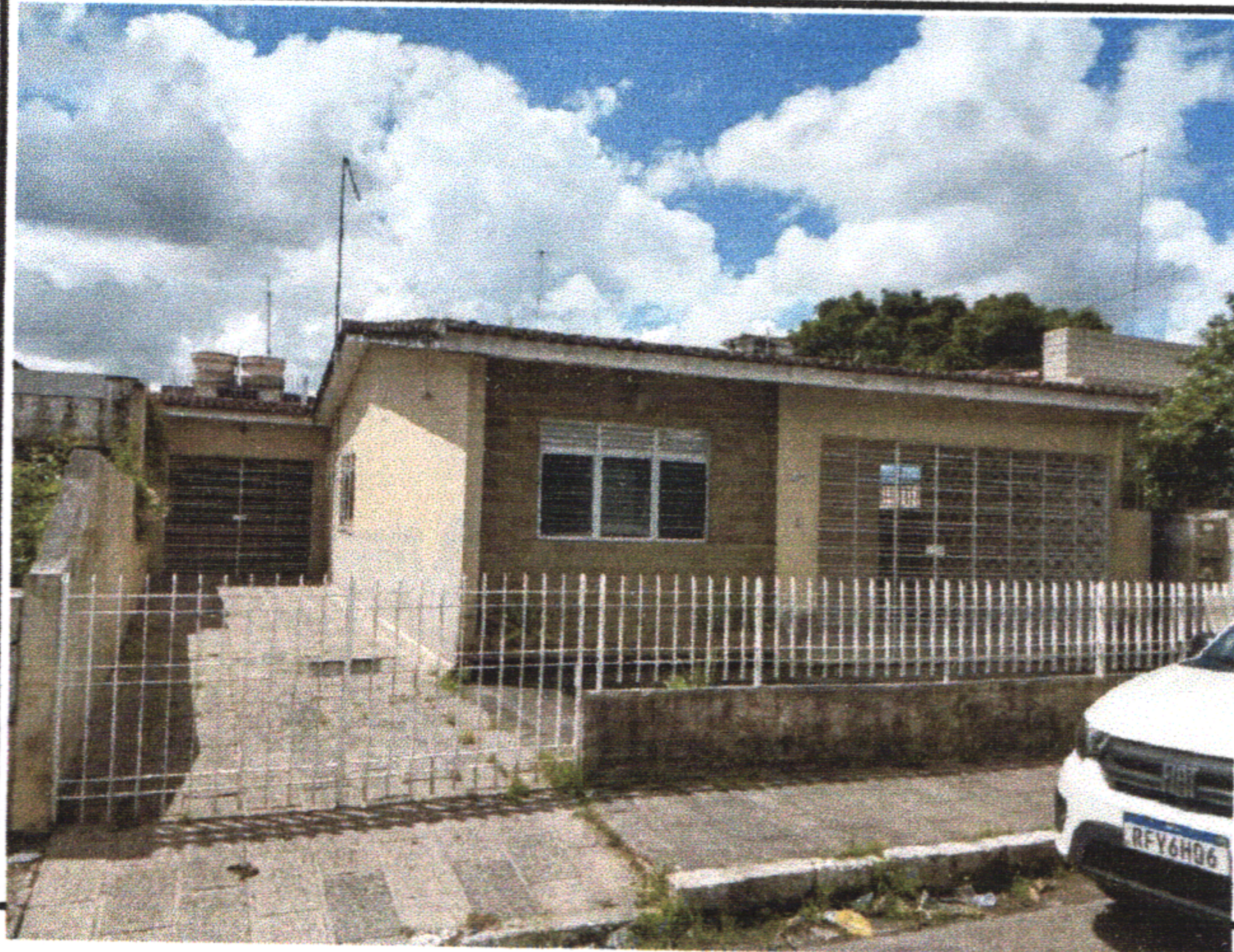
Pintura externa das paredes deteriorada e gramíneas nos rejuntas das lajotas da garagem
