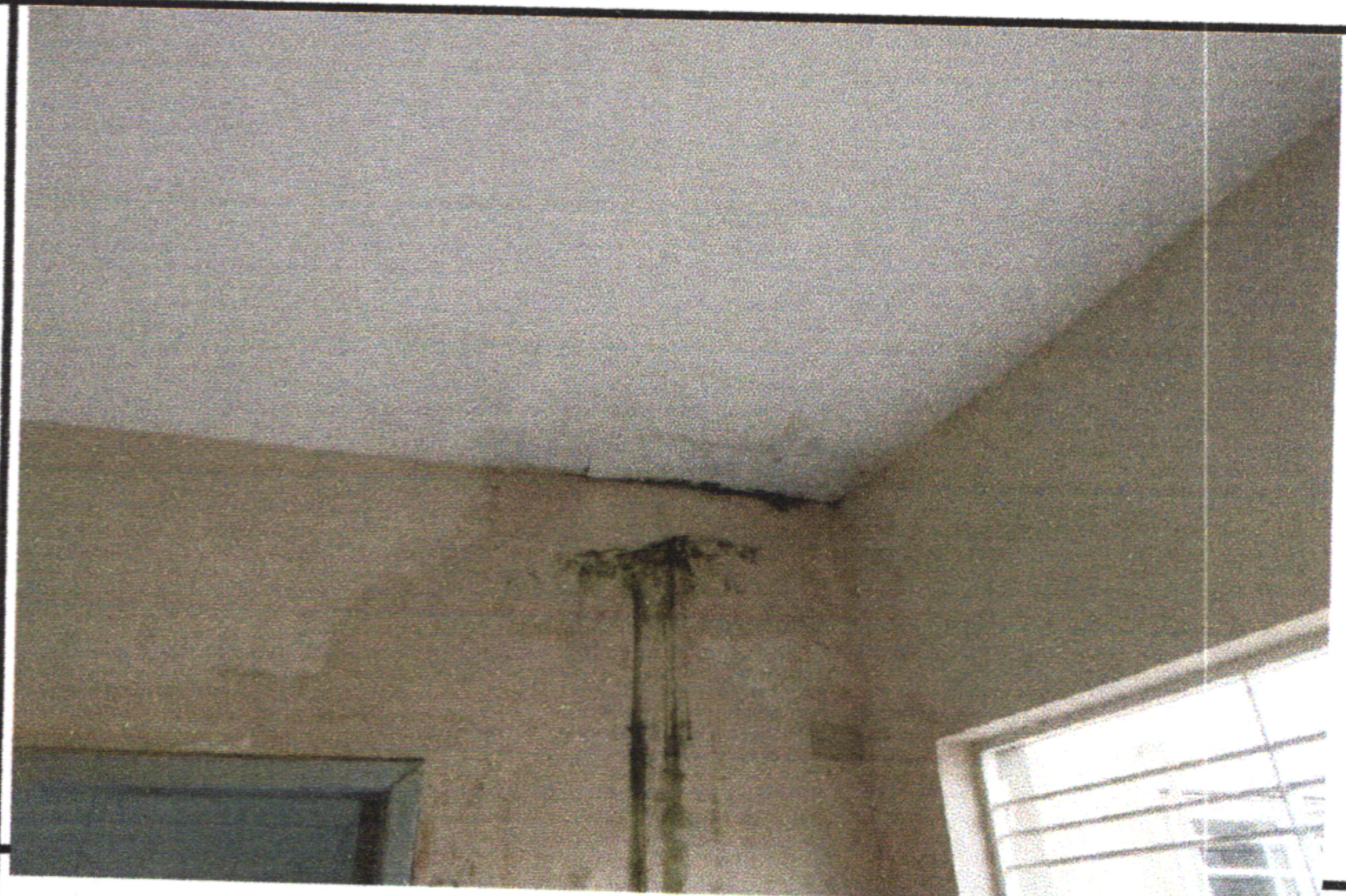
Vazamento na calha
